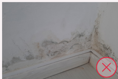
Remontée capillaire active
