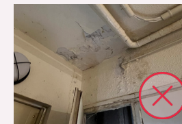
Cage d'escaliers dégradée
