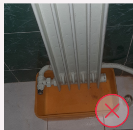
Fuite au niveau du radiateur
