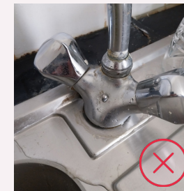
Fuite au niveau du robinet
