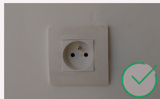
Installation électrique sécurisée et conforme
