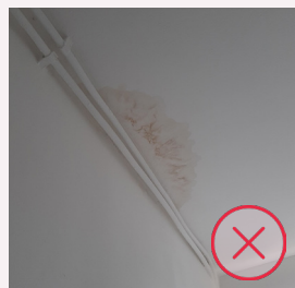
Infiltration suite à un dégât des eaux
