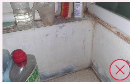
Installation de la douche non étanche
