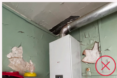
Infiltration suite à plusieurs dégâts des eaux et des parois non étanches
