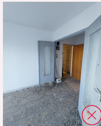
Logement non-décent : installation électrique avec risque d'électrocution, porte d'entrée non sécurisée, présence de nuisibles, revêtement intérieur dégradé...
