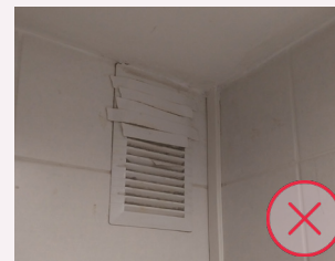
Grille haute obstruée
