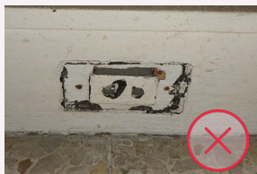
Ancienne installation électrique non sécurisée
