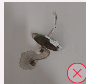
Luminaire non sécurisé : fils apparents et dénudés
