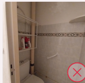
Absence d'entrée et d'extraction d'air
