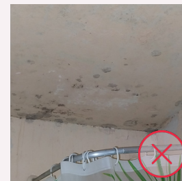
Infiltration au niveau de la toiture et traces importantes de condensation
