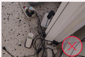
Installation électrique insuffisante et risque de surtension
