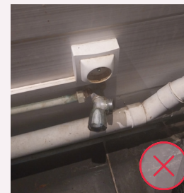
Installation électrique à proximité du réseau d'eau
