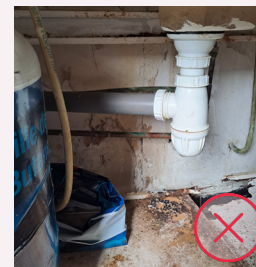
Fuite au niveau du siphon
