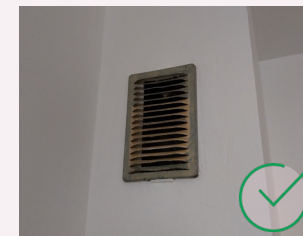
Grille haute conforme
