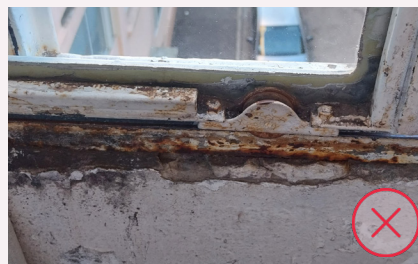
Menuiseries extérieures non étanches
