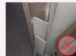
Cloison instable et vétuste
