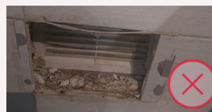
Grille basse incomplète et non entretenue
