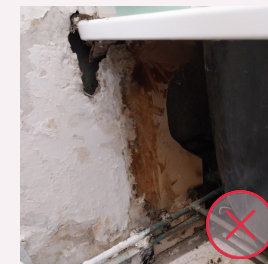
Installation de la baignoire incomplète et non étanche
